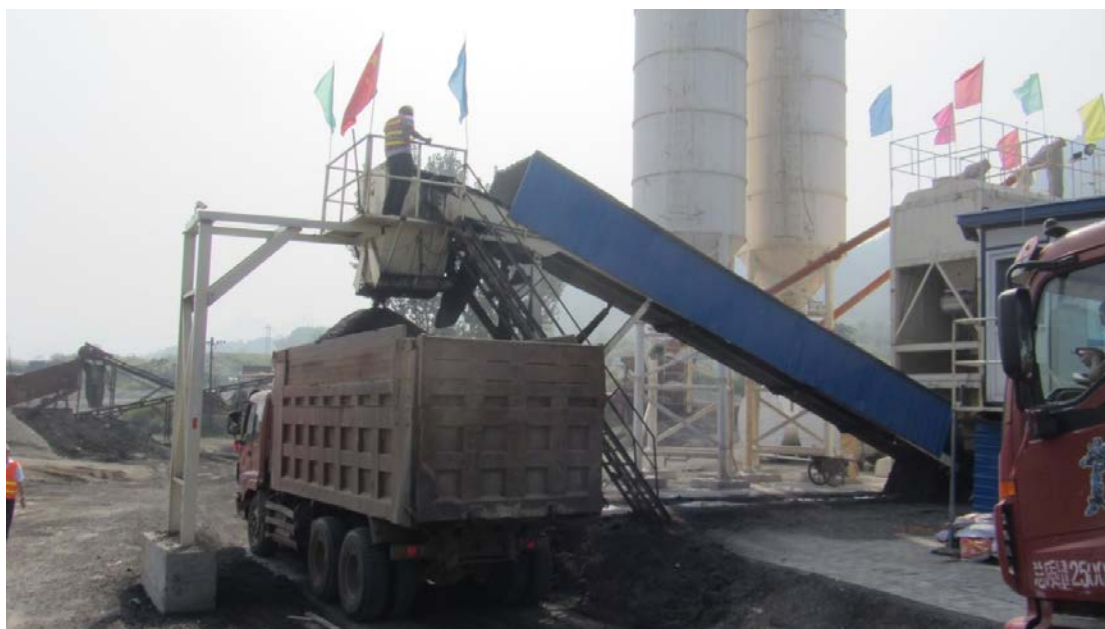
图17-厂拌冷再生装置
