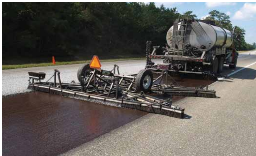
Superior: Figura 6 - Aplicación de un tratamiento superficial de riego con gravilla Inferior: Figura 7 - Scrub seal
